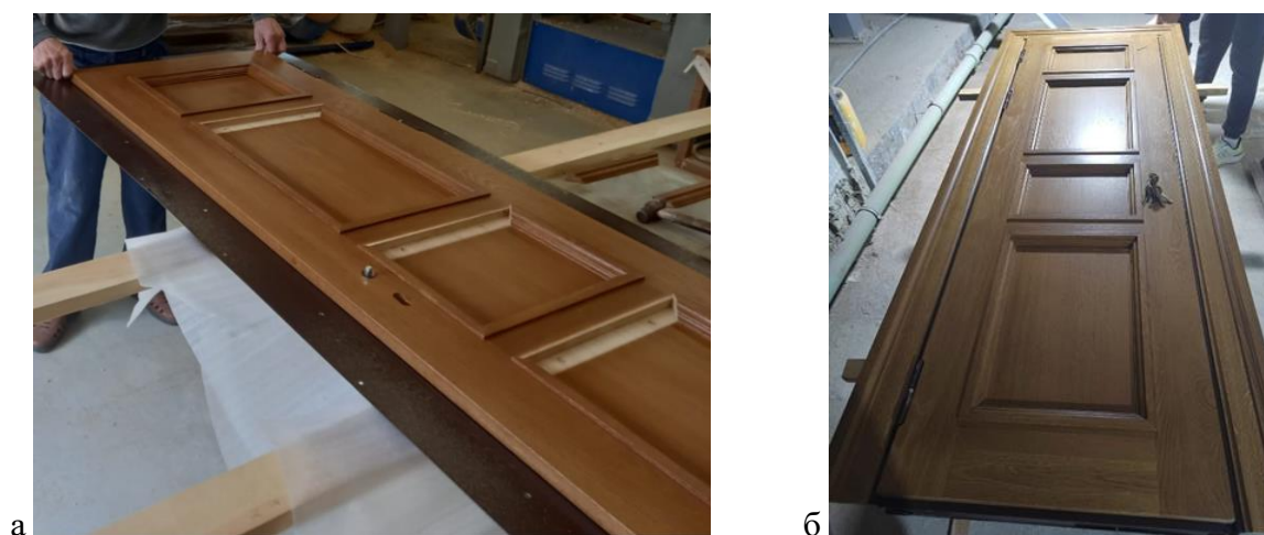
Рис.1. Противопожарный дверной блок с деревянными накладками: а – процесс изготовления и обшивки в реставрационной мастерской; б – готовый дверной блок перед монтажом
