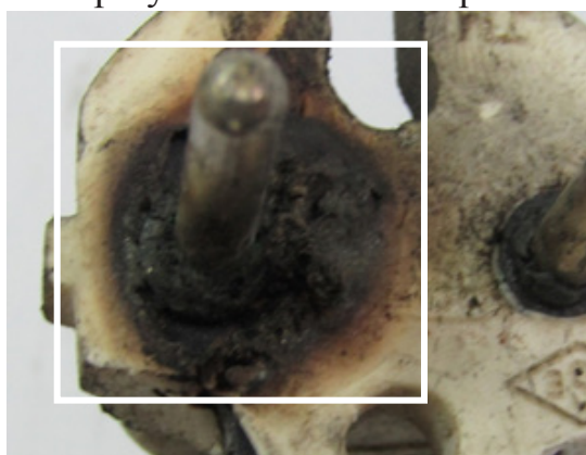
Рис. 4. Локальное потемнение на поверхности корпуса штепсельной электровилки в месте контактного соединения
